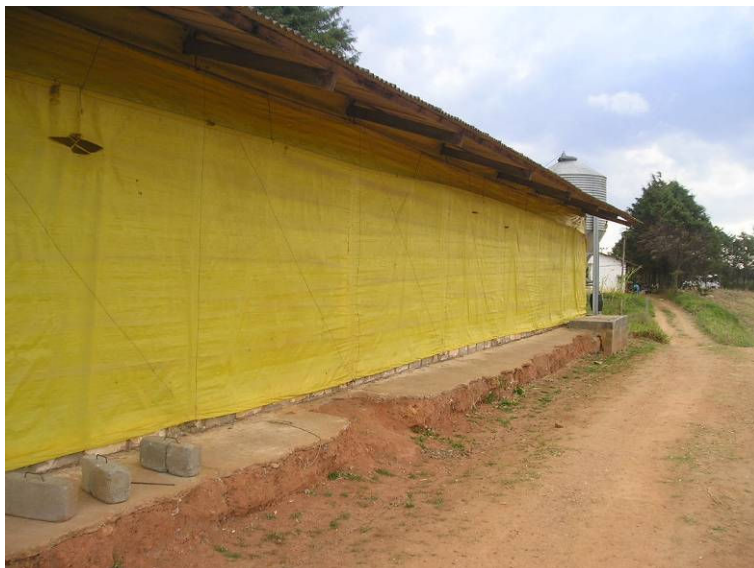
Figura 43. Vista externa da cortina do galpão de frangos de corte em Barbacena, Minas Gerais
