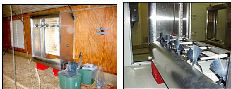
FIGURA 4. Ilustração do sistema de avaliação de ventiladores instalado no galpão e detalhe dos anemômetros no laboratório.
