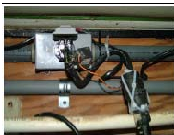
FIGURA 10. Detalhe do Sensor de Corrente Elétrica Instalado no Cabo de Energia do Ventilador, destinado a monitorar o tempo de funcionamento do mesmo.
